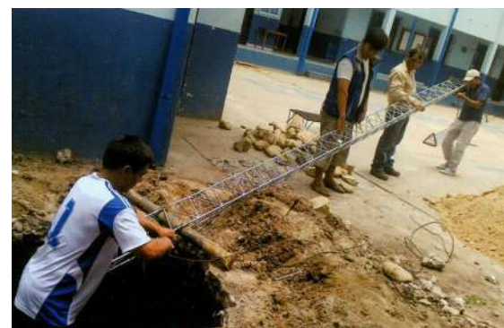
Maestros de la Unidad Educativa “Lucio Siles” proceden con la instalación de la antena de la Radio Educativa.
